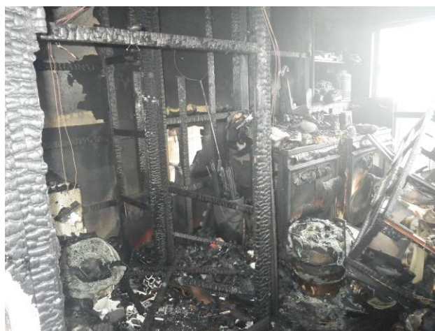
建物火災鎮火後の状況
