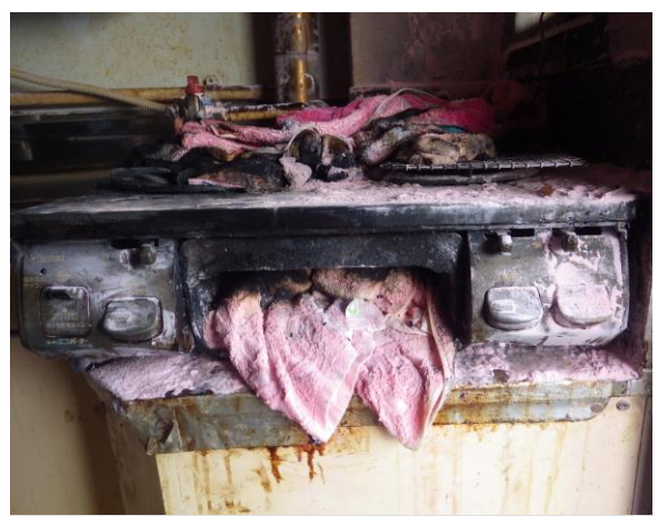
ガステーブルコンロの状況
