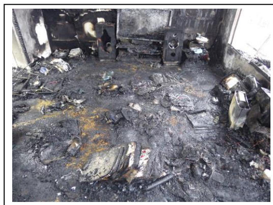
建物火災鎮火後の状況
