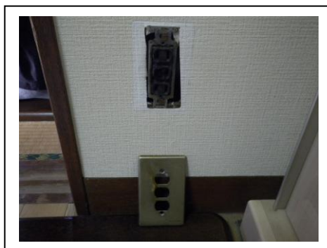
電気コードが焼けた状況
