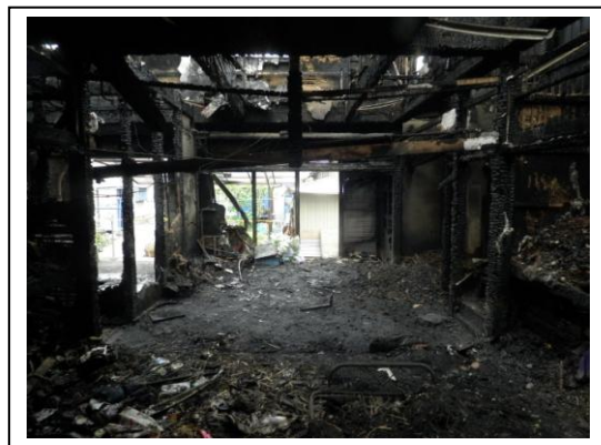
建物火災鎮火後の状況
