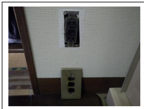
電気コードが焼けた状況
