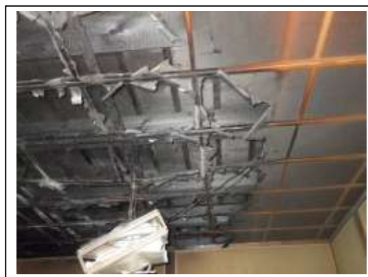
建物火災鎮火後の状況
