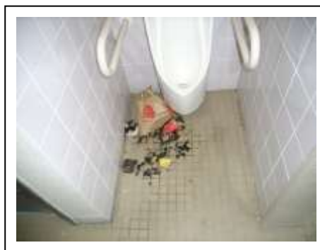
ごみ類が燃えた状況
