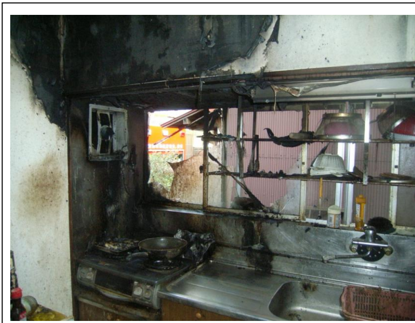
写真 2 - 4 - 2 「焼損した台所の状況」
