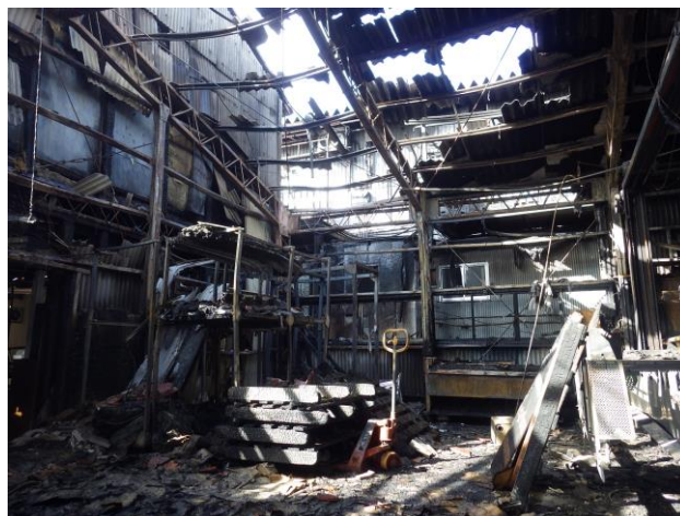
建物火災鎮火後の状況
