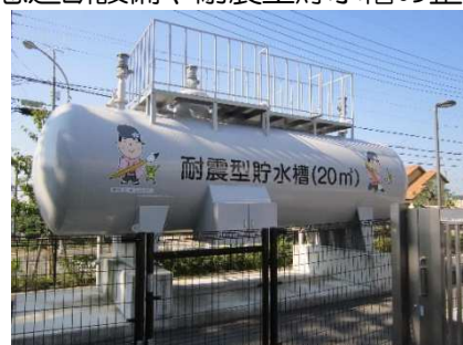
耐震型貯水槽（藤山台小学校）
