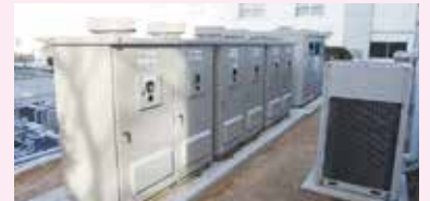
中部大学(蓄電池)
