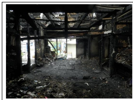
建物火災鎮火後の状況
