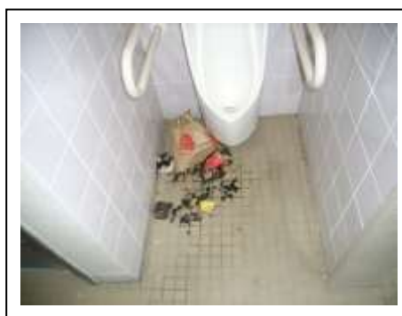
ごみ類が燃えた状況
