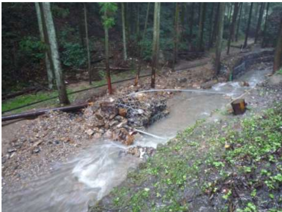
護岸崩落箇所（北西から）
