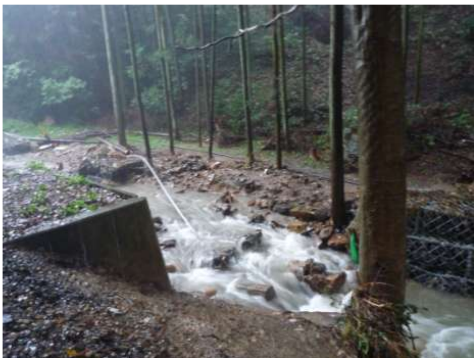
護岸崩落箇所（南西から）
