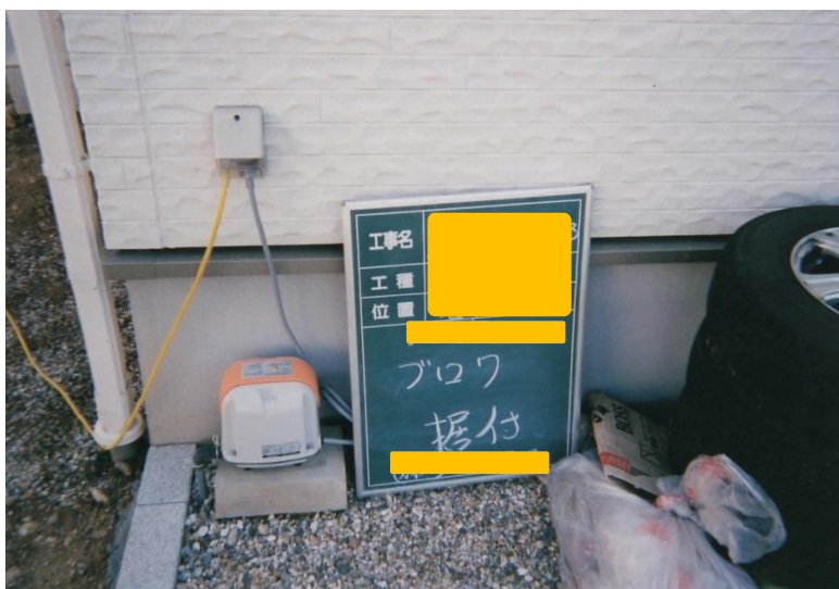
ブロワ設置状況
