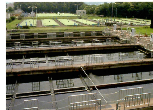
エアレーションタンクと最終沈殿池
