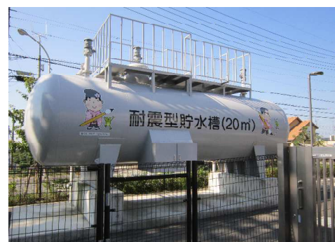
耐震型貯水槽（藤山台小学校）
