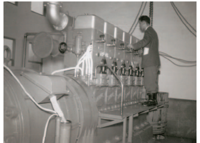
鳥居松浄水場・ディーゼル発電機
