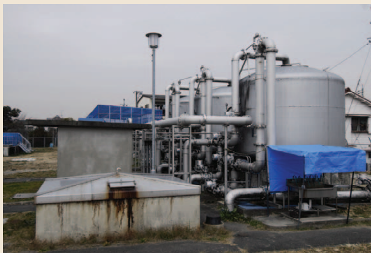
町屋町・町屋送水場 加圧ろ過機
