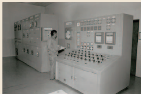
廻間給水場・制御盤
