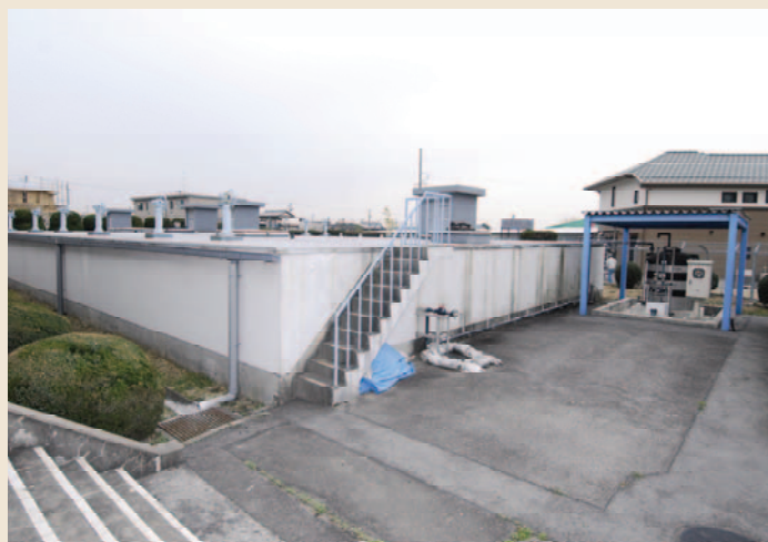
桃山町・県水受水ポンプ場 受水池
