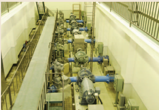
県水受水ポンプ場 送水ポンプ室
