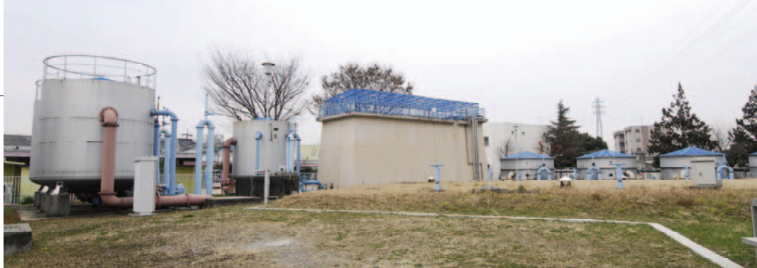
町屋送水場急速ろ過器
