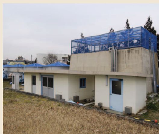
知多配水場凝集沈殿池
