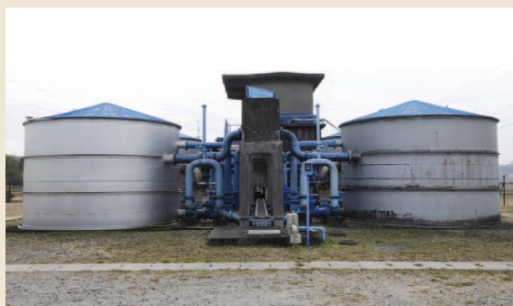
廻間送水場重力式急速ろ過機
