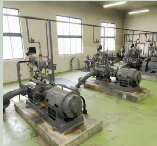
廻間送水場ポンプ室
