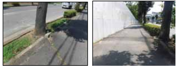
図2-14 街路樹による路面の損傷例
