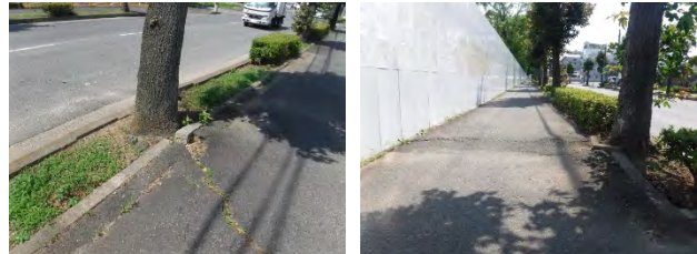
図2-14 街路樹による路面の損傷例
