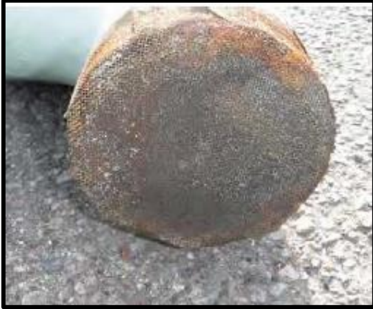
経年による目詰まり
