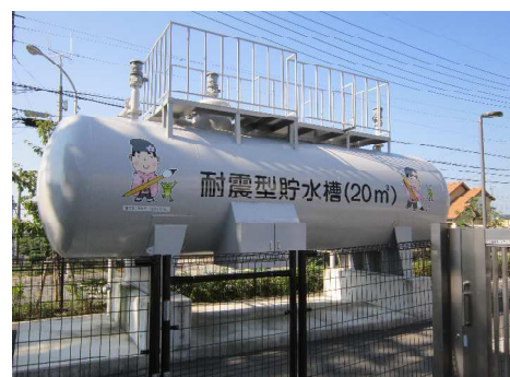
耐震型貯水槽 (藤山台小学校)
