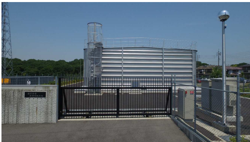
東神明配水場ステンレス配水池
