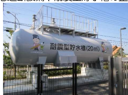
耐震型貯水槽（藤山台小学校）
