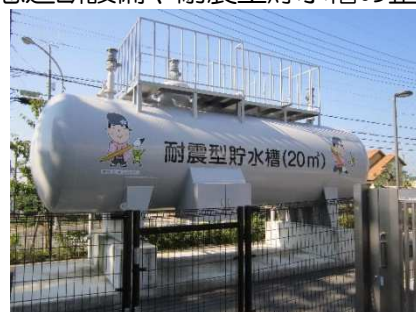
耐震型貯水槽（藤山台小学校）
