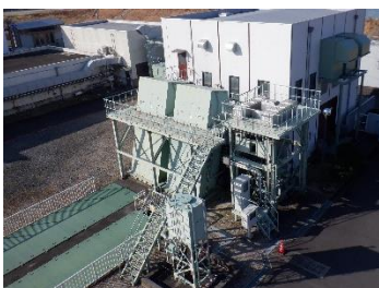
勝西ポンプ場
