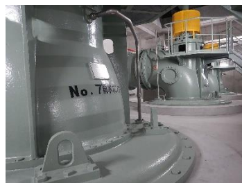
南部ポンプ場
