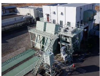
勝西ポンプ場
