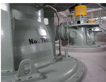
南部ポンプ場
