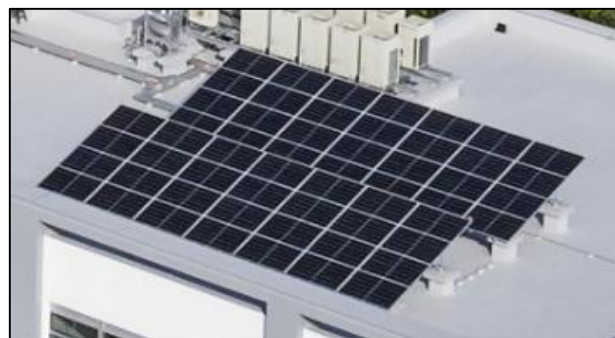
②太陽光発電設備
