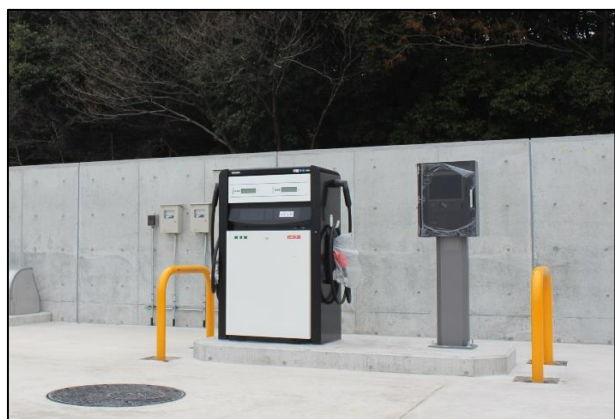
①自家用給油取扱所
