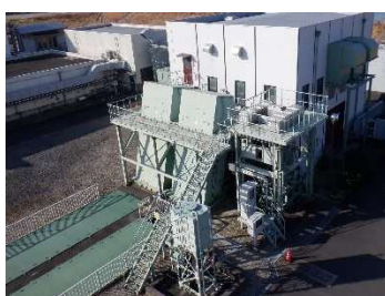
勝西ポンプ場
