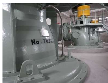
南部ポンプ場
