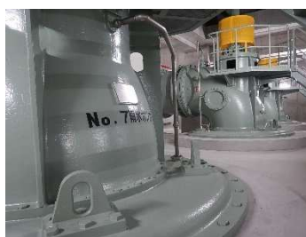
南部ポンプ場
