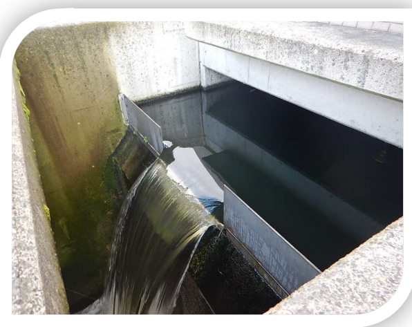
【処理水(浄化センター)】
