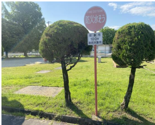
飲料水兼用耐震性防火水槽
