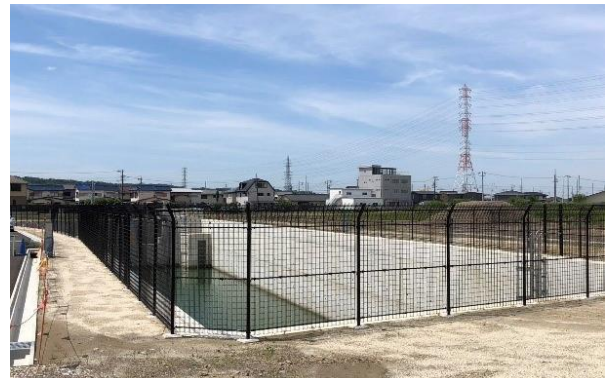
熊野桜佐雨水3号調整池
